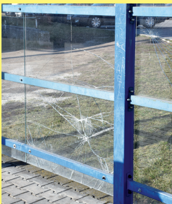
Poškodené sklo na zastávke
